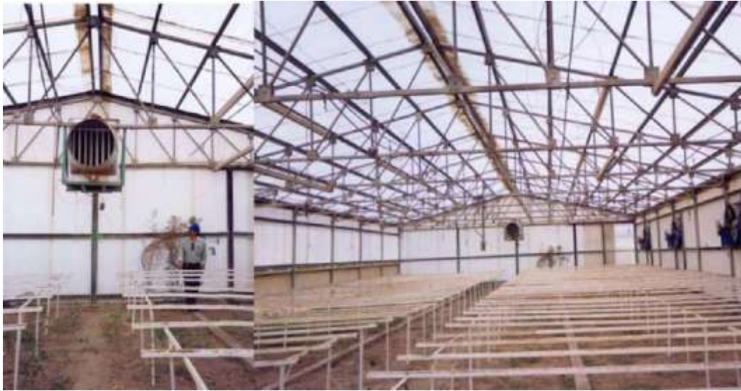
Figura 2-74. Foto de Armadura tipo Pratt usado en invernadero
