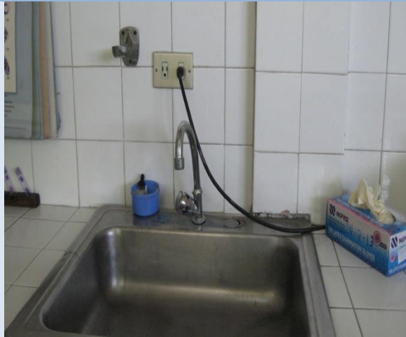
Tomacorrientes sobre los lavados
