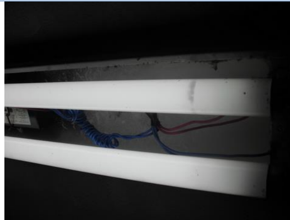
Lámparas en mal estado
