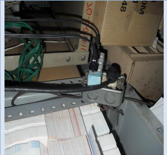
Conexiones eléctricas improvisadas
