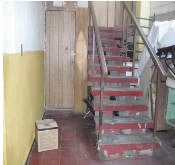
Gradas en mal estado
