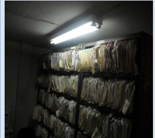
La iluminación en mal estado y en posición riesgosa
