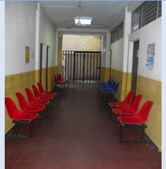
Pasillo sin señalización
