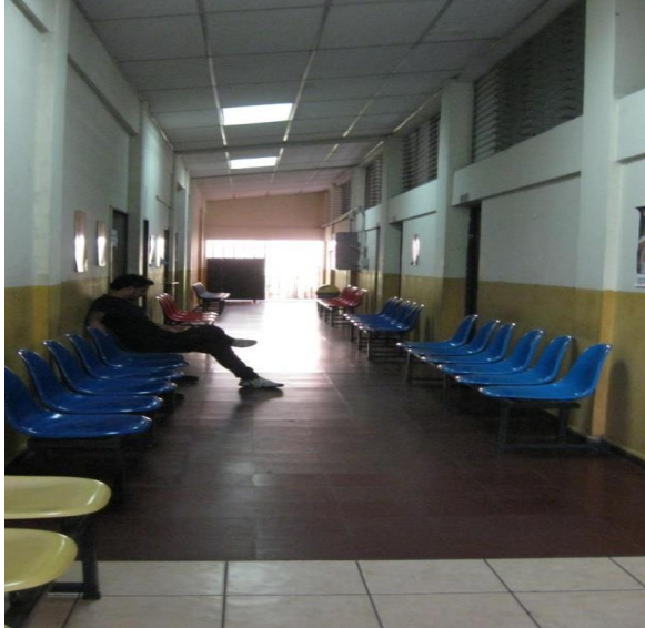
Pasillos sin ningún tipo de señalización
