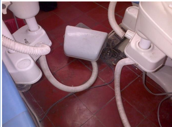
Conexiones eléctricas descubiertas
