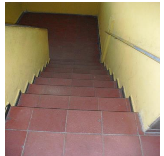
Gradas inclinadas sin pasamanos
