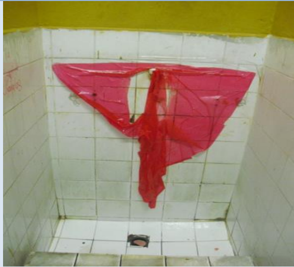
Servicios sanitarios en mal estado e insalubres
