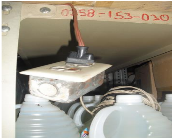
Tomacorrientes en posiciones riesgosas
