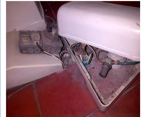
Cables en mal estado
