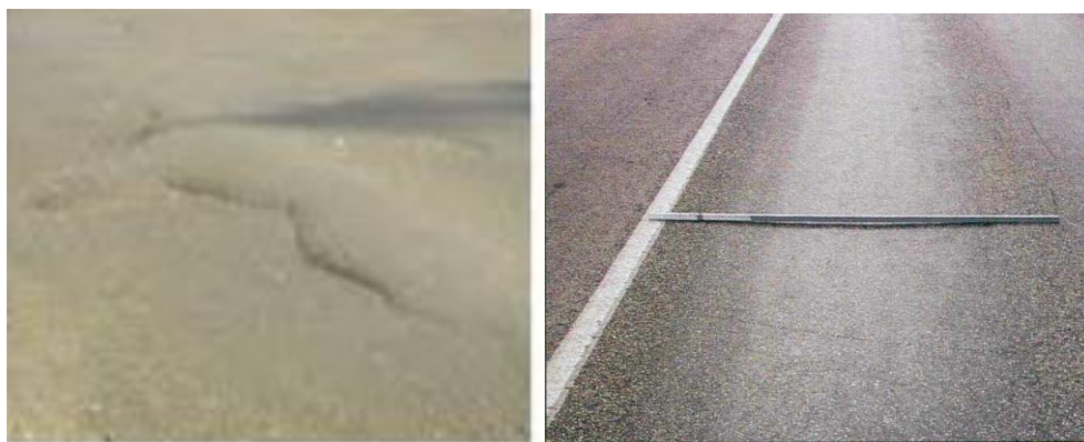
Figura 2.10: Deformación permanente de carpeta asfáltica
