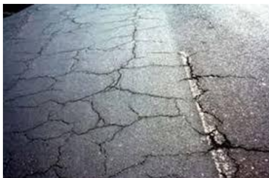
Figura 2.9: Imagen que muestra el agrietamiento de la capa asfáltica
