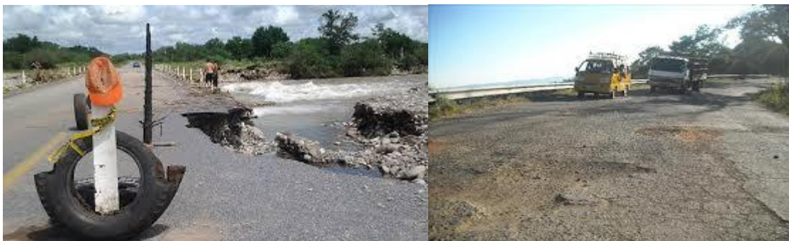
Figura 2.25: Efecto del deterioro del pavimento
