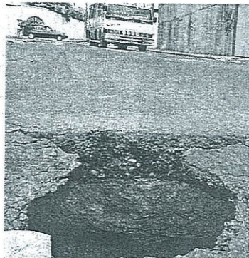
HUNDIMIENTO en la 2a. Avenida Norte, entre la 11a. y 13a. Calle Oriente del centro de la capital.
