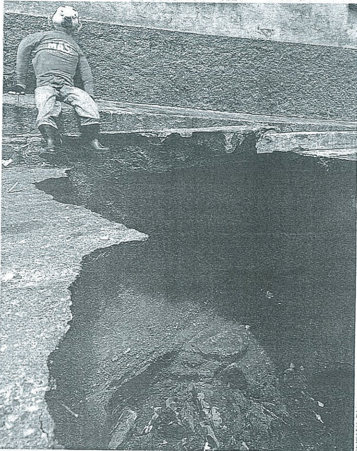
LA CASA 301, UBICADA ENTRE EL FINAL DE LA 24a. Avenida Norte y Calle El Tamarindo, de la colonia San Judas, de la capital, está en riesgo por una cárcava formada por una fuga de agua potable.
