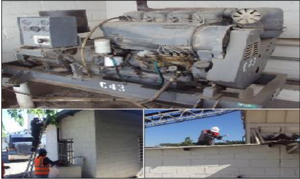
Figura No. 26 Realización de cuantificación de gases en fuentes fija (Generador eléctricos)
