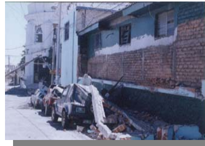
(Foto #14), DAÑOS PARCIALES EN EDIFICACIONES POR SISMOS 2001. Ubicación: Calle Lic. Hernán Miranda.
