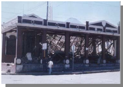
(Foto #19), CASINO VICENTINO. (SEVERAMENTE DAÑADO POR SISMOS 2001) Ubicación: Frente al Costado Sur del Parque Cañas.
