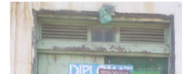
DETALLE DE TIMPANO DE MADETA TIPO PERCSIANA Y VIDRIO FIJO EN EL CENTRO
