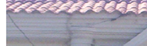
DERALLE DE CORNISA Y NOTESE LA CUBIERTA DE FIBROCEMENTO COLOR ROJO SIMULANDO TEJA
