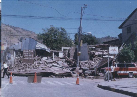
(Foto #17), DESTRUCCIÓN POR SISMOS EN EDIFICACIONES.
