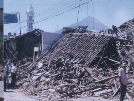
(Foto #18), VIVIENDAS DESTRUIDAS POR SISMOS 2001. (notese el material de la estructura de la cubierta que era de madera y teja).
