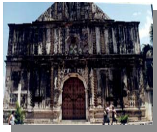
IGLESIA DE NUESTRA SEÑORA DE EL PILAR. (En proceso de reconstruida) Ubicación: Ave. Crescencio Miranda y Calle Alberto Merino.
