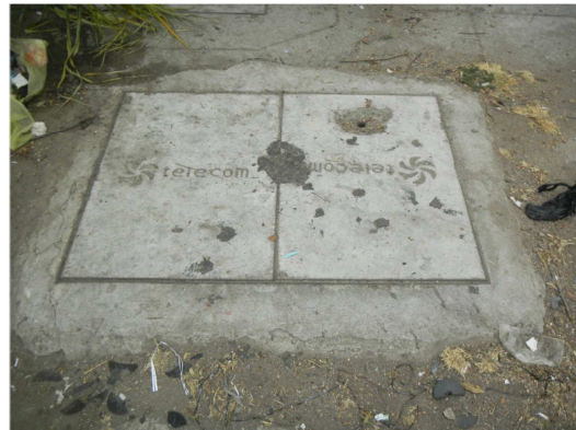
FOTO # 33 Pozo de Registro Telefonía, sobre acera Calle Turrialba
