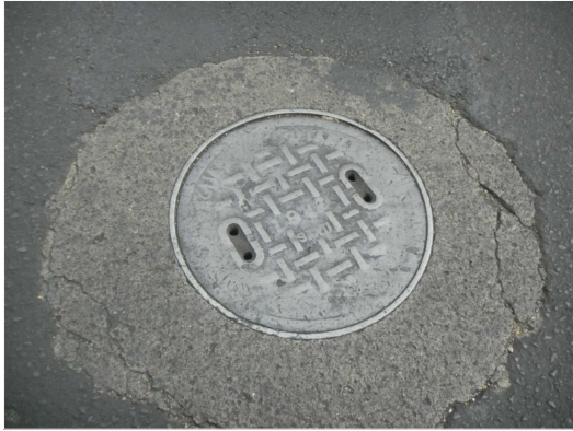
FOTO # 30 Pozo Agua Potable sobre Av. Alajuela
