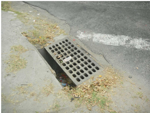
FOTO # 32 Caja Tragante sobre Calle Turrialba
