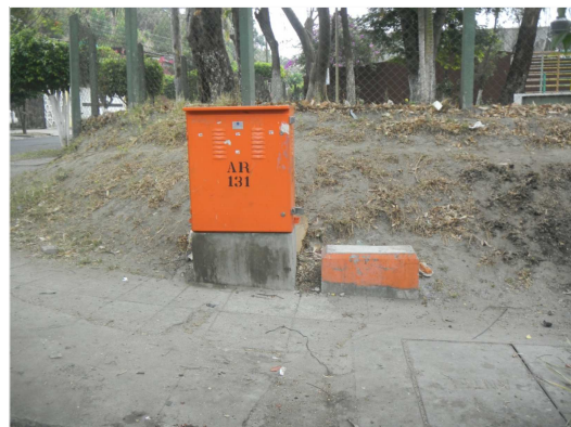
FOTO # 35 Gabinete Telefonico sobre acera Calle Turrialba
