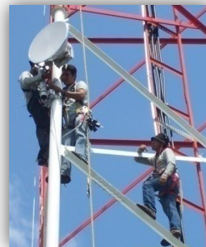
Fotografía 15: Posturas inadecuadas para la colocación de antenas
