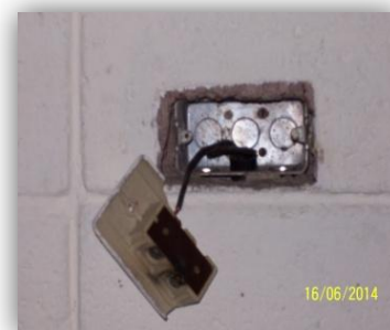
Fotografía 6: Conductores eléctricos en mal estado
