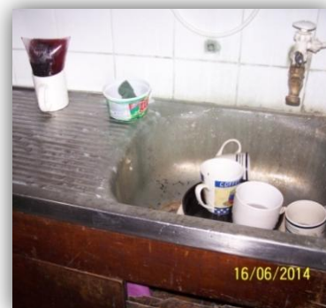
Fotografía 12: Grifos conectados al filtro de agua
