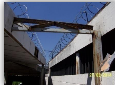
Fotografía 1: Estructuras en mal estado
