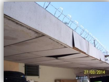
Fotografía 2: Cielos falsos deteriorados
