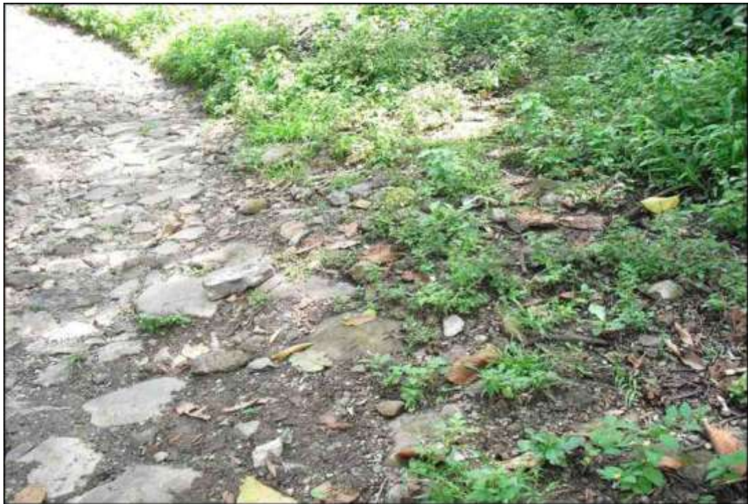
Anexo 2: Caminos sin obra de drenajes.
