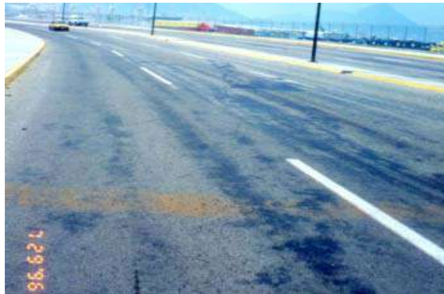
Fotografías 2.8. Exudación en pavimento asfáltico 25 .
