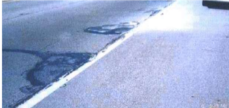
Fotografías 2.13. Bombeo de finos en pavimentos asfálticos 30 .
