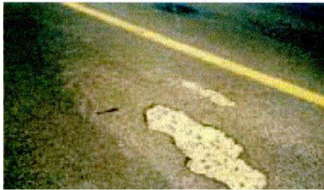
Fotografías 2.10. Segregación longitudinal en pavimento asfáltico 27 .
