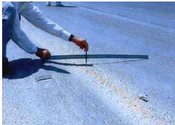
Fotografía 2.14. Deformación plástica permanente en pavimento asfáltico 31 .
