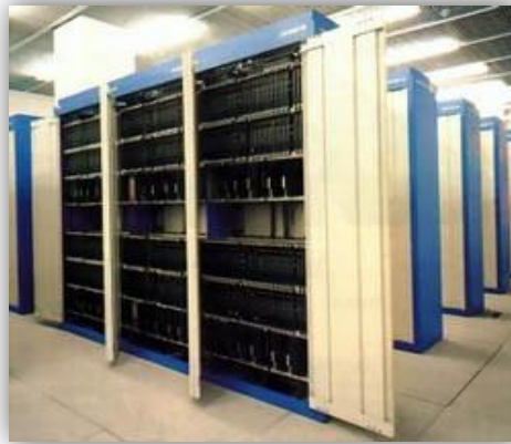
Figura 4. Sistema de conmutación temporal para 10,000 líneas, del Sistema 12 de Alcatel. Estos sistemas comenzaron a ser utilizados a partir de los años 60's. [4]
