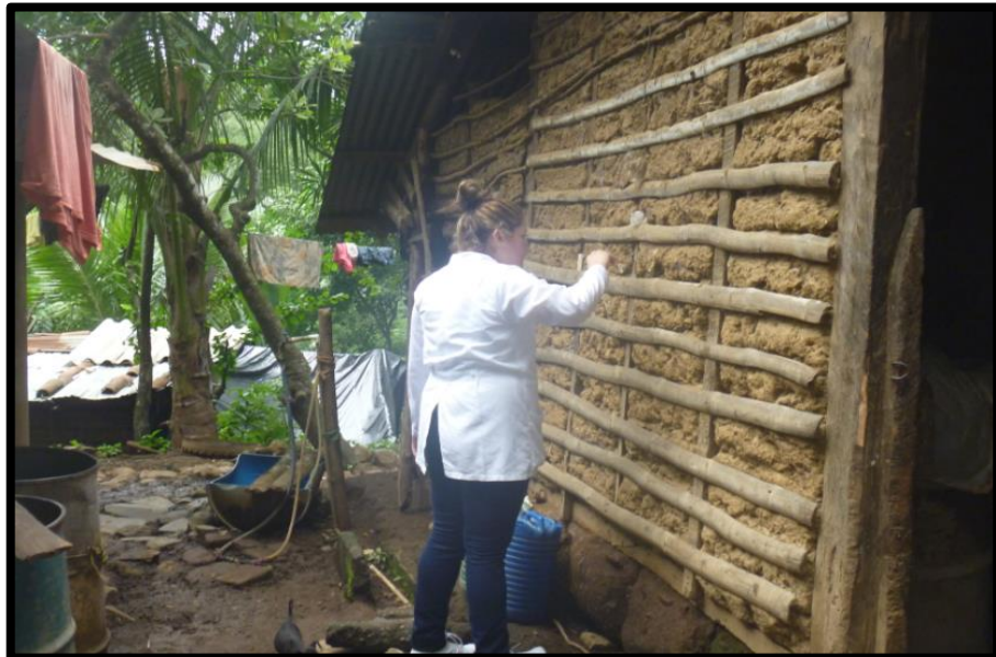
Fig.17: Búsqueda de chinches en paredes de adobe.
