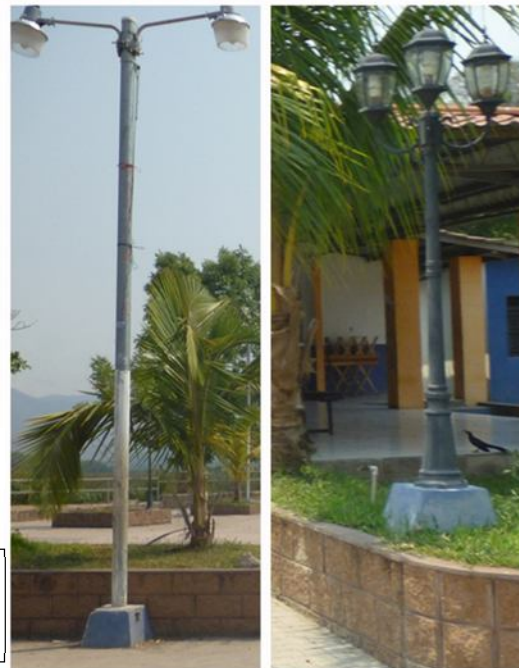
Luminarias con cableado subterráneo
