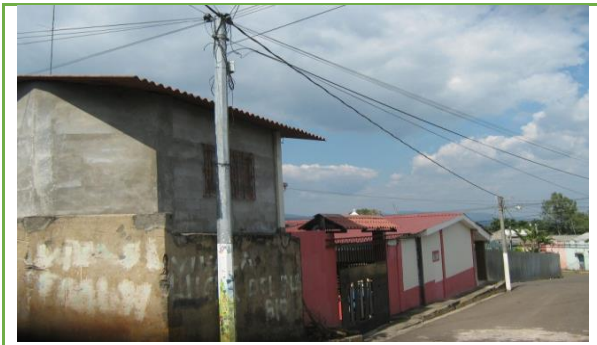
Imagen n°9: cableado de luz eléctrica. Fuente: propia
