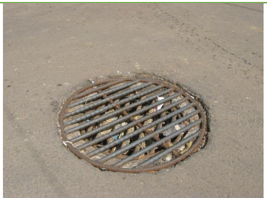
Imagen n°8: alcantarilla de aguas lluvias en la calle principal del municipio. Fuente: propia
