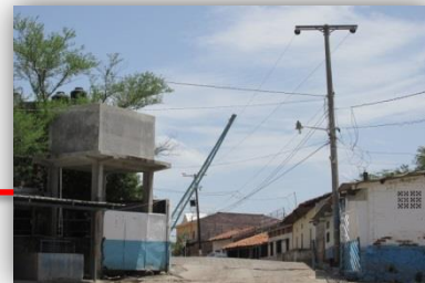
Cometida de electricidad
