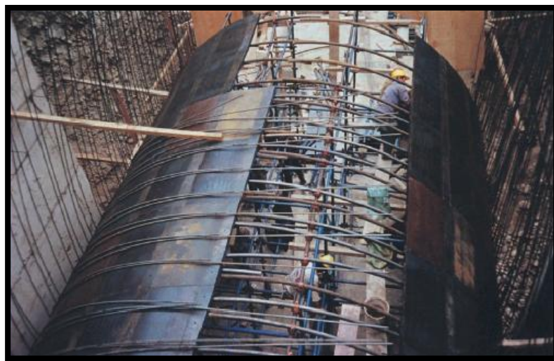
Figura 35: Encofrado para túnel de menor longitud. ( Técnica en la construcción, Cesar Urbina Huertas, documento PDF ).
