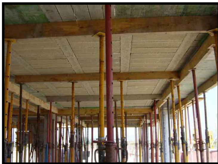
Figura 32: Colocación de puntales de refuerzo en losa ligera. ( Guía práctica de encofrados, Instituto Vasco de Seguridad y Salud Laborales, España ).
