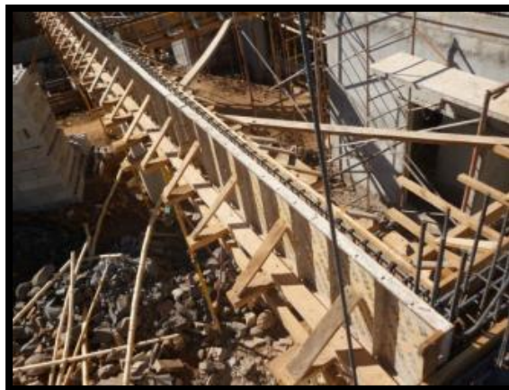
Figura 27: Encofrados para vigas en El Salvador. ( Construcción de alcaldía municipal de Yucuaiquin, La Unión, El Salvador ).
