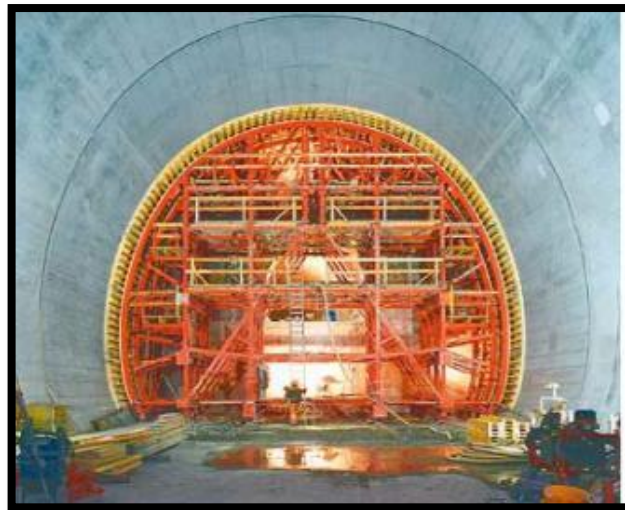
Figura 33: Encofrado especial para túnel. ( Túnel Flüelen, Suiza )
