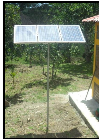
Imagen 29. Panel solar existente
