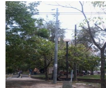
Imagen # 23 Poste con Transformador
