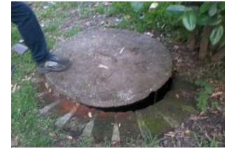
Imagen # 21 Pozo de lluvias
