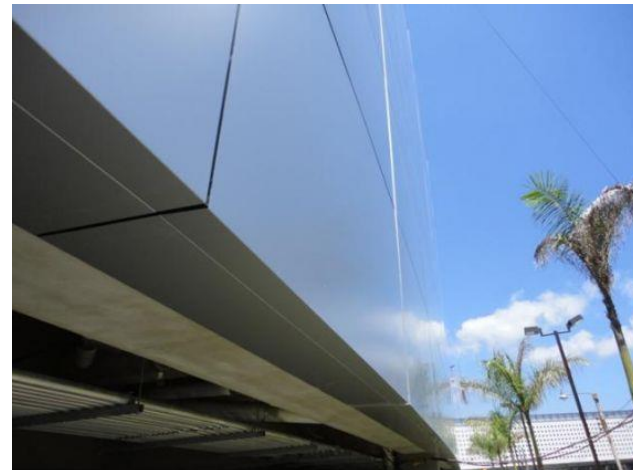
Imagen #54 ejemplo de implementación de los paneles de aluminio
