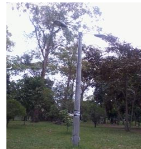
Imagen # 22 Poste metálico para iluminación
