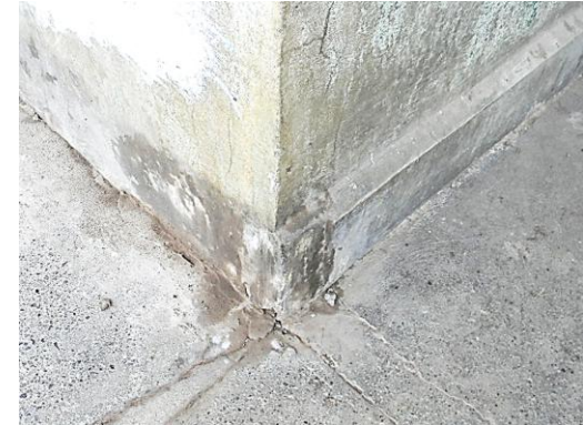
Figura 78 Eflorescencias en base de paredes. Fuente: Elaboración Propia
