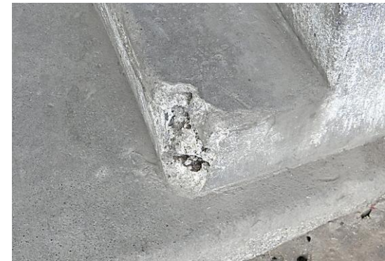
Figura 77 Desprendimientos en escaleras de acceso. Fuente: Elaboración Propia
