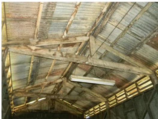
Figura 68 Vista de lámpara provisional existente en el interior del inmueble. Fuente: Elaboración Propia
