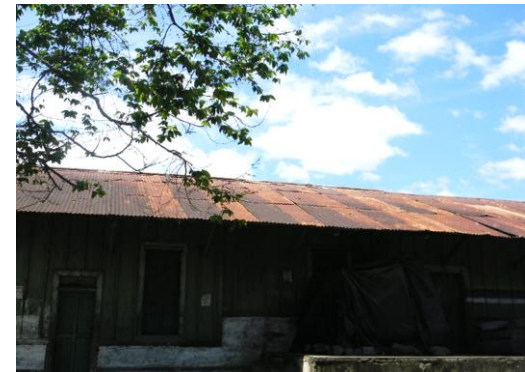
Figura 79 Oxidación completa de la cubierta de techo. Fuente: Elaboración Propia
