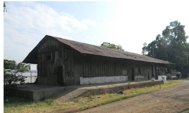
Figura 72 Estado actual de la estación Fachada Posterior. Fuente: Elaboración Propia
