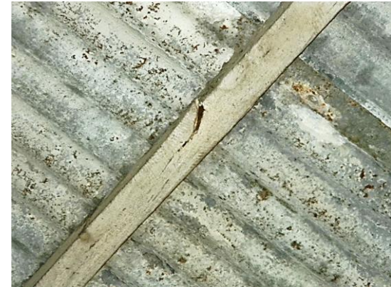
Figura 76 Fisuras en vigas de techo. Fuente: Elaboración Propia
