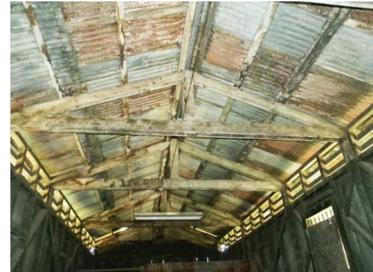
Figura 81 Erosión química en cubierta y estructura de techo. Fuente: Elaboración Propia
