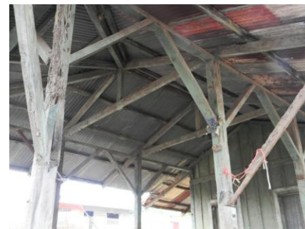
Figura 70 Lesiones observables a simple vista en estructura de techo de la estación. Fuente: Elaboración Propia
