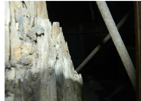
Figura 74 Erosión en la estructura de madera. Fuente: Elaboración Propia
