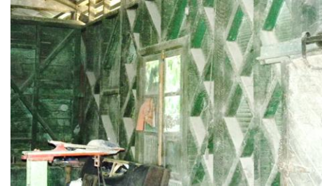
Figura 73 Suciedad en la estructura interna de paredes. Fuente: Elaboración Propia
