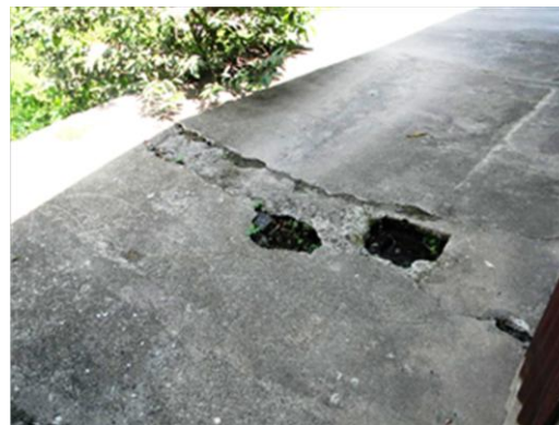
Figura 67 Conexión exterior improvisada de aguas negras. Fuente: Elaboración Propia
