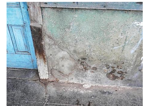
Figura 75 Grietas exteriores en la estructura inferior de la base de paredes. Fuente: Elaboración Propia
