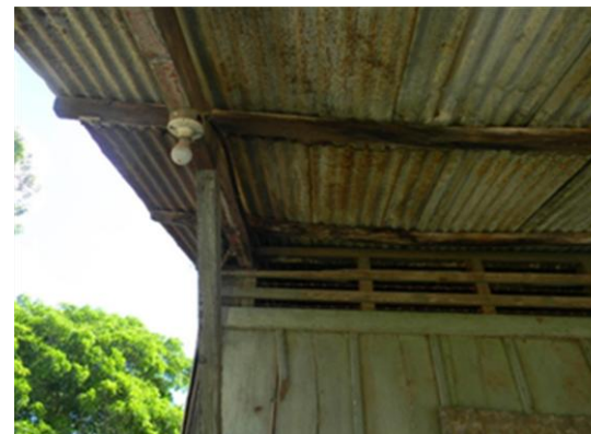
Figura 69 Vista de bombillo provisional existente en el exterior del inmueble. Fuente: Elaboración Propia
