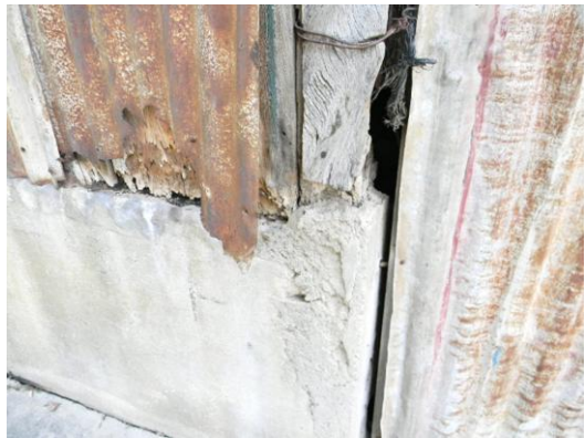
Figura 82 Erosión en paredes y desprendimiento de material. Fuente: Elaboración Propia
