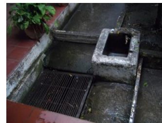
Imagen 25: Canaleta y caja tragante para aguas lluvias
