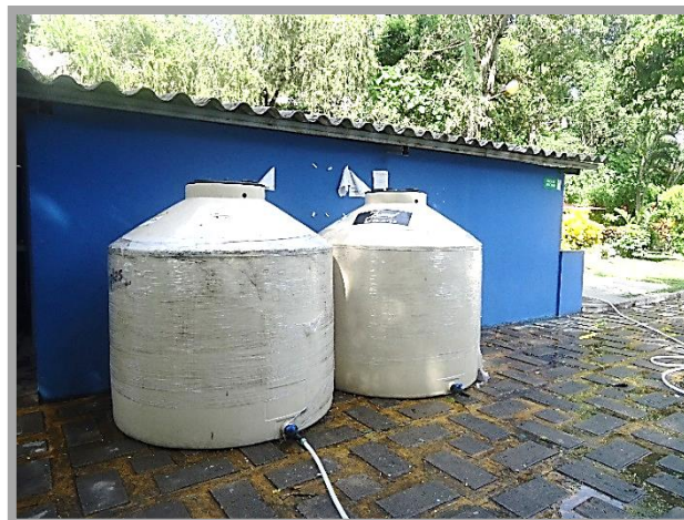
FOTO 14: Tanques provisionales de agua potable.
