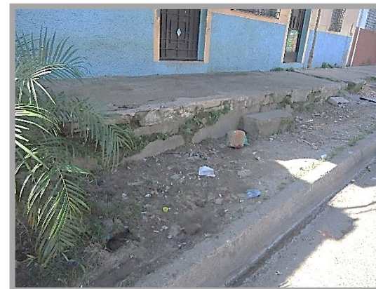
FOTO 65: Acera en mal estado sobre la 23 Calle Poniente.
