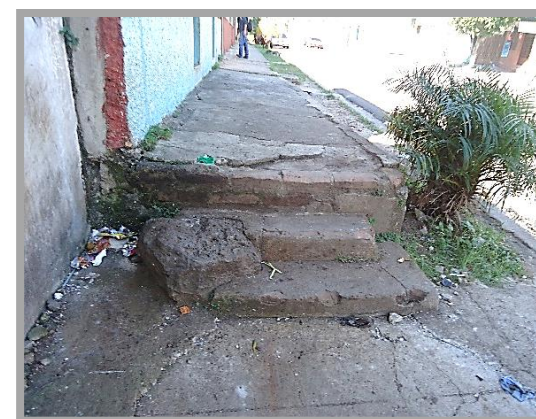
FOTO 66: Gradas en mal estado.
