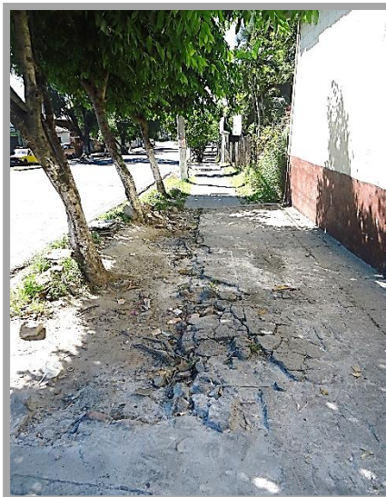
FOTO 64: Acera en mal estado cercana al acceso principal del centro.
