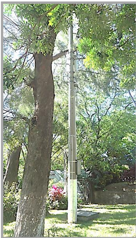
FOTO 13: Poste de transformador.
