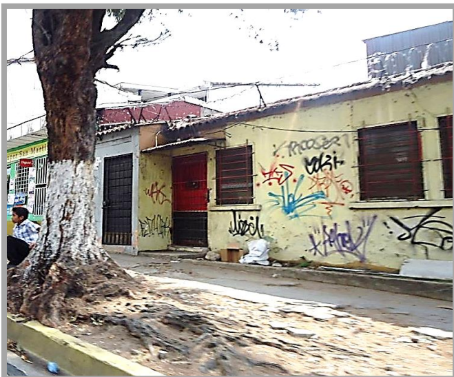
FOTO 63: Acera en mal estado sobre la 5ª Avenida Norte.
