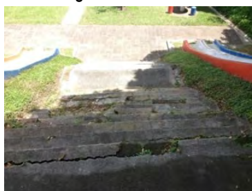
Imagen N°28: Gradas en mal estado
