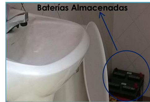
Ilustración 2.50. Baterías en Servicio Sanitarios.
