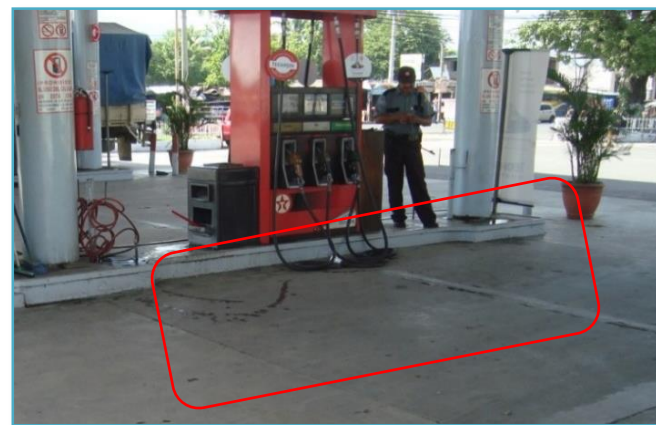
Ilustración 2.123. Área de Expendio de combustible No señalizada.
