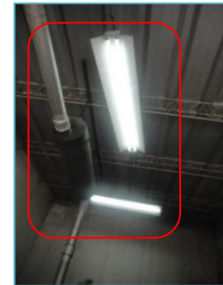
Ilustración 2.129. Tubería de Emanación de Humo próxima a Lámpara.
