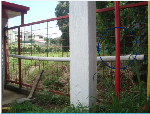
Ilustración 2.106. Acceso a vara de medición de combustible obstruido.
