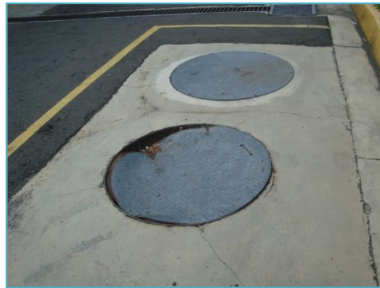
Ilustración 2.149. Tapadera de Bomba Sumergible Deteriorada.
