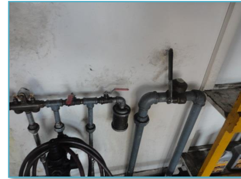
Ilustración 2.70. Válvulas de accionamiento del Elevador Hidráulico.
