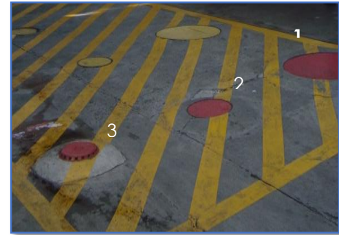
Ilustración 2.26. Salidas externas de tanques subterráneos.
