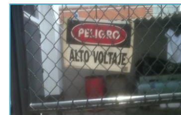
Ilustración 2.42. Señalización de Alto Voltaje.
