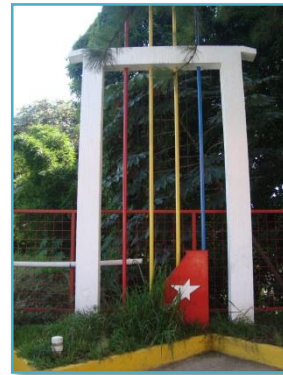
Ilustración 2.109. Ausencia de Protección contra impacto vehicular tubería de venteo.
