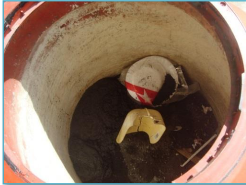
Ilustración 2.145. Arena contaminada y desechos sólidos.
