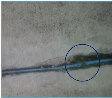
Ilustración 2.108. Aislante Deteriorado (Cuarto de Maquina).
