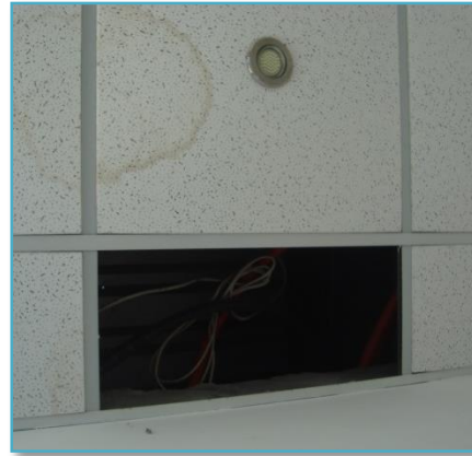
Ilustración 2.107. Techo deteriorado (Servicios Sanitarios Público).
