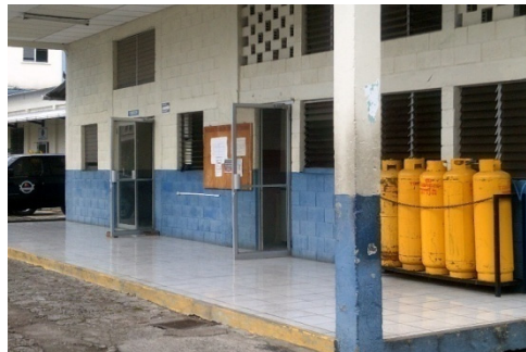
Fotografía: Cocina y comedor para uso de los empleados, estos cuentan con las instalaciones necesarias aunque de la misma manera no cuenta con el equipamiento necesario para desarrollar sus actividades.
