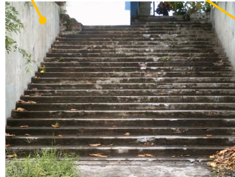
Fotografía La inexistencia de rampas para personas discapacitadas dificultad a muchas personas que poseen capacidades especiales que hacen usos de los servicio de la entidad.
