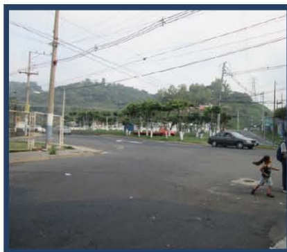
Fig.61 Foto actual del sistema eléctrico
