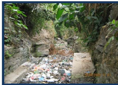
Fig.94 Foto actual de quebrada el Piro.
