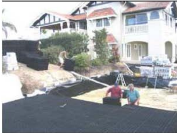
Figura 11. Depósito de detención enterrado.
