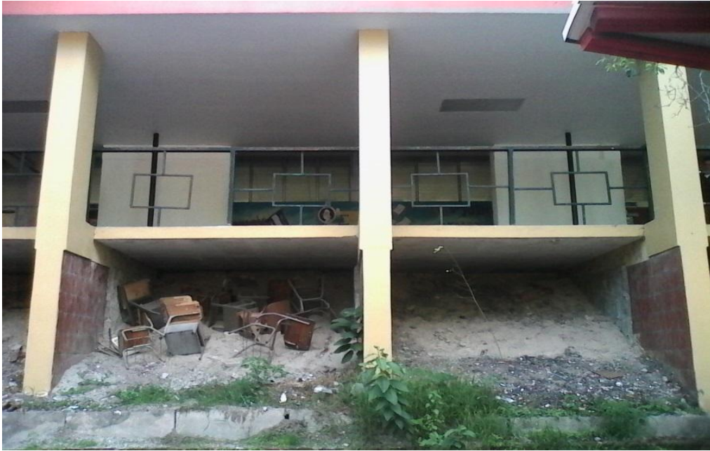
Existencia de mobiliario obsoleto que genera contaminación física.
