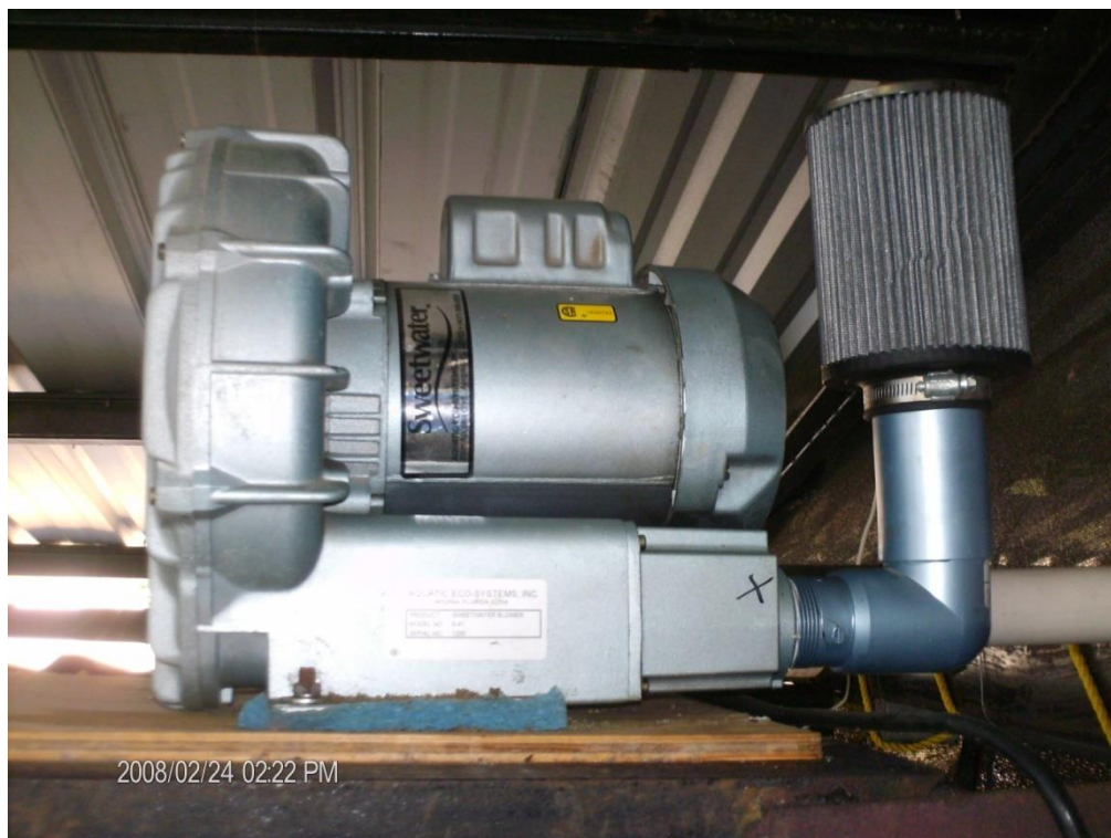
Anexo 4. Compresor regenerativo utilizado para abastecer de oxígeno a los tanques de adaptación
