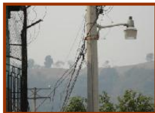
Fotografía III-35: Exceso de cables en alumbrado público.
