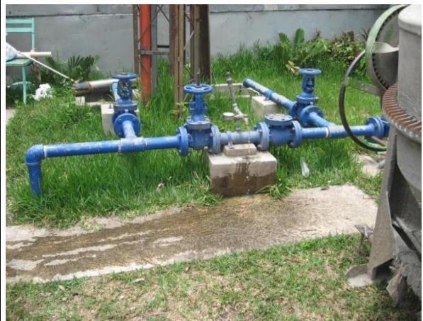
Pozo Industrial en comunidad Casco Urbano, cantón Nuevo Cuscatlán, municipio Nuevo Cuscatlán.
