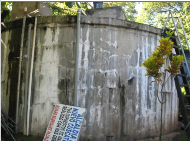
Tanque de distribución Casco Urbano, cantón Nuevo Cuscatlán, municipio Nuevo Cuscatlán.
