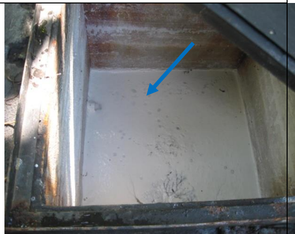
Dispositivo de cloración en Casco Urbano, cantón Nuevo Cuscatlán, municipio Nuevo Cuscatlán.
