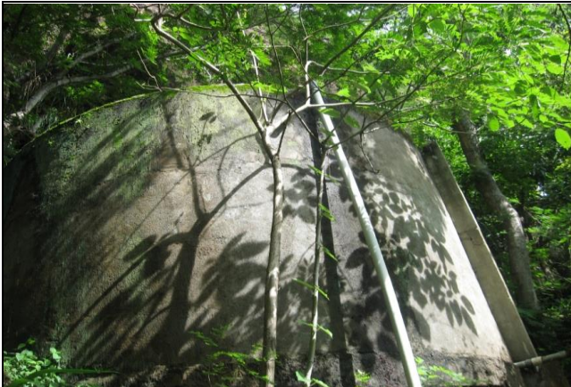
Tanque de distribución del sistema Agua Escondida No. 2, cantón Guadalupe, municipio Zaragoza.
