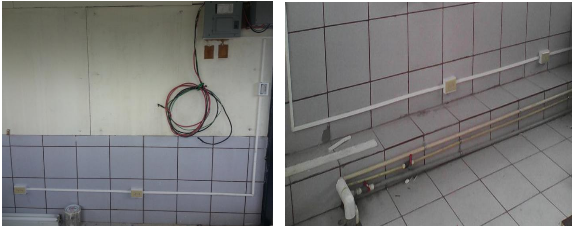
Figura A. 4: Parte de la instalación eléctrica realizada en el laboratorio. [46]
