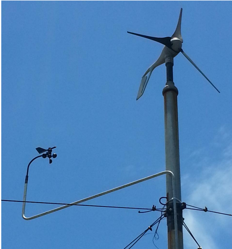
Figura 110: Instalación de Anemómetro y veleta, sujeta al mástil que sujeta al generador. [46]
