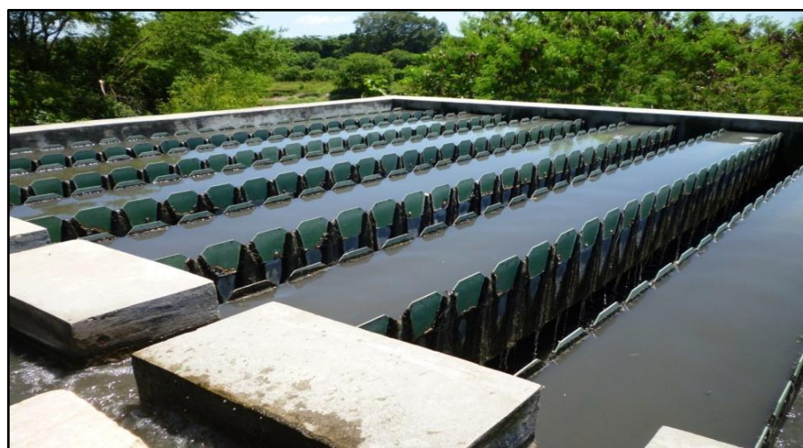
Figura 7. Vertederos para distribución de aguas en la parte superior del filtro biológico.
