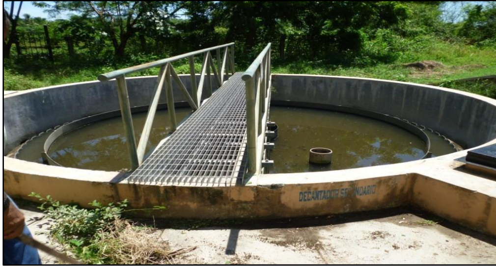
Figura 8. Decantador secundario de la PTAR de San Luis Talpa.
