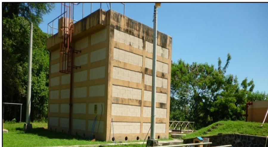
Figura 6. Filtro biológico de la PTAR de San Luis Talpa.
