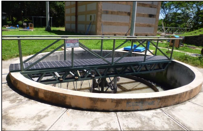
Figura 5. Decantador primario en la PTAR de San Luis Talpa.
