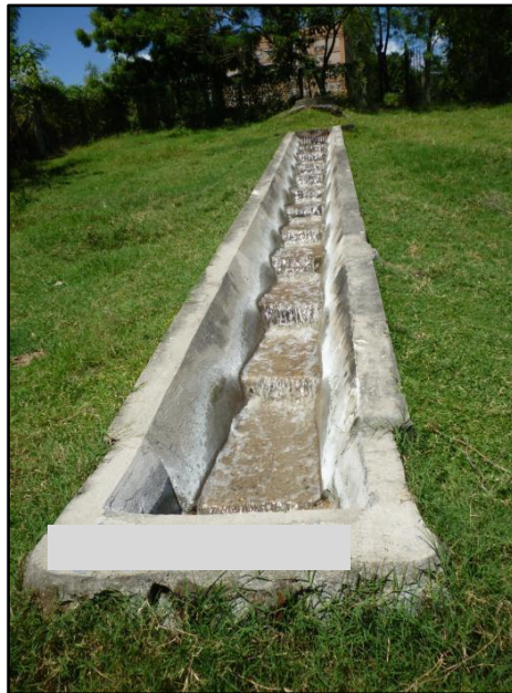
Figura 9. Gradas de aireación de la PTAR de San Luis Talpa.
