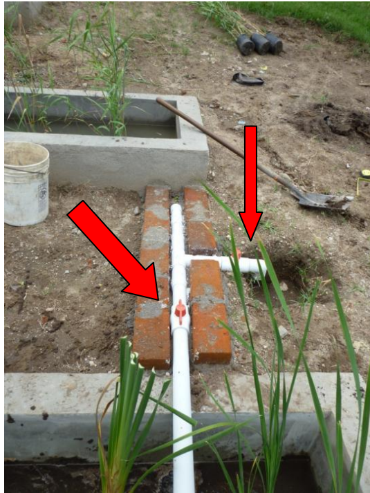
Figura 16. Tubería de PVC y válvulas para control de flujo en los humedales.
