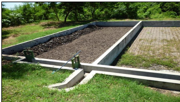
Figura 11. Patios de secado de lodos de la PTAR de San Luis Talpa.
