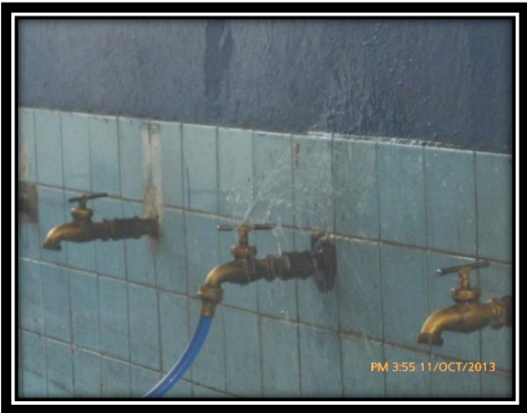
Grifo en mal estado que genera desperdicio de agua.
