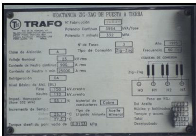
Figura 6.5. Placa del transformador de puesta a tierra de la subestación Nejava.
