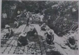
ADOQUINADO MIXTO. Entusiastamente, la comunidad del Barrio San José, J/El Divisadero, construye su adoquinado mixto, que pronto estará terminado.
