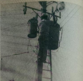
ALUMBRADO PUBLICO. El Refugio, Ahuachapán. Trabajadores de la CEL instalan lámparas de mercurio para el alumbrado público en esta localidad, las cuales fueron proporcionadas por la municipalidad que preside Arturo Cazin.
