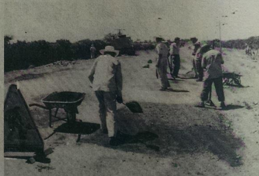
REPARAN VIA LITORAL. Usulután. Cuadrillas de trabajadores de Caminos realizan aceleradamente trabajos de reparación de la carretera del Litoral, en el tramo que conduce a San Marcos Lempita.
