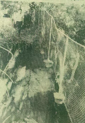
PIDEN CONSTRUIR MURO. (Santa Ana). Padres de familia y alumnos del Instituto Nacional de Santa Ana (INSA) piden a las autoridades construir un muro donde se encuentra el taller de electricidad, que se ha lavado y pelagra derrumbarse.
