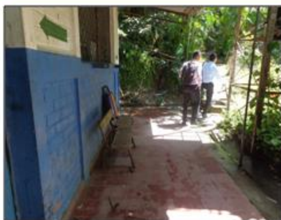
Area inadecuada para los estudiantes
