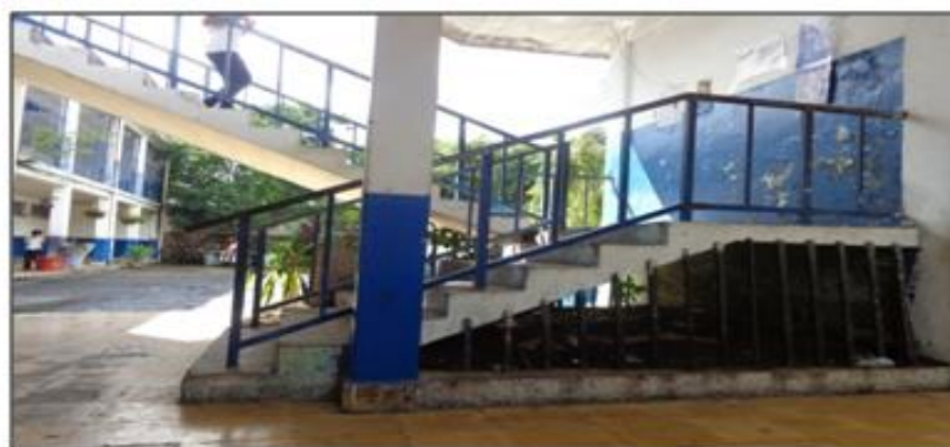
Gradas que conducen al segundo nivel, el cual se observa que no está adecuado para estudiantes con dificultades físicas
