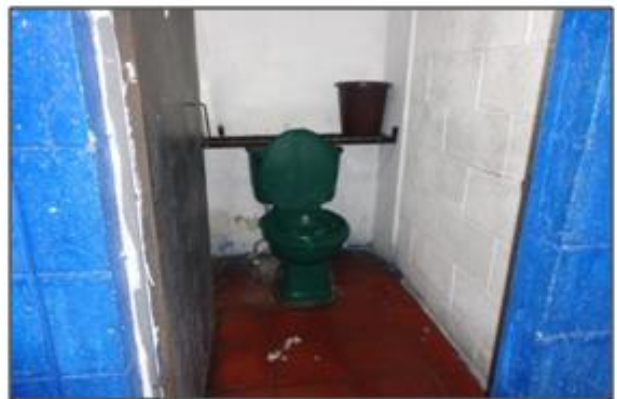
Condiciones de los servicios sanitarios
