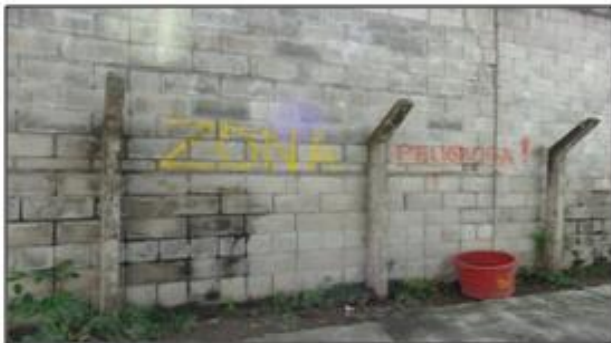
Muro que limita al centro educativo de las comunidades aledañas, denominada como zona peligrosa para los estudiantes
