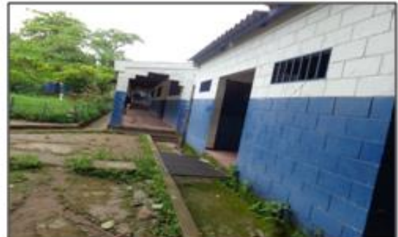
Área donde se ubica los servicios sanitarios, se puede observar que el acceso para estudiantes con Necesidades Educativas Especiales no es posible
