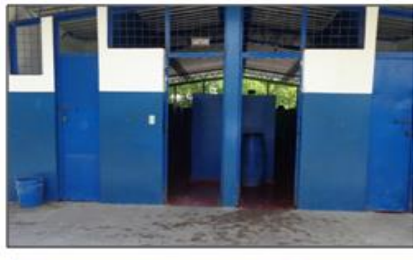
Servicios sanitarios, se puede observar que no existe adecuación para atender estudiantes con Necesidades Educativa Especial
