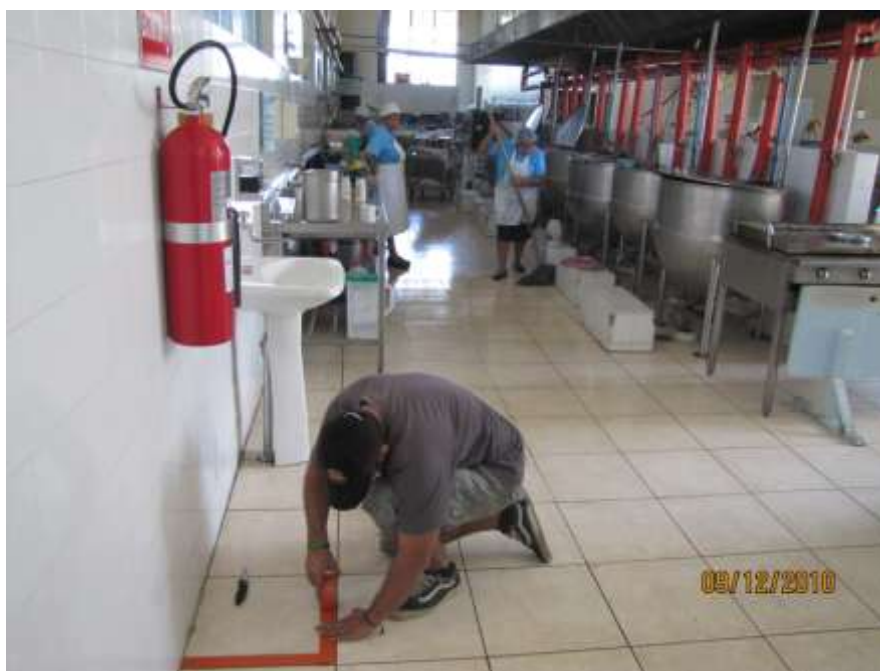
Imagen No. 5.5. Colocación y delimitación del área de los Extintores.
