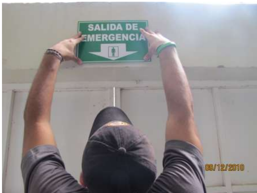
Imagen No. 5.6. Colocación de Señales de Emergencia en el Departamento.
