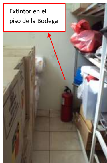
Imagen No.1.3 Ubicación de Extintor
