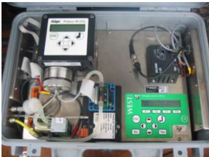
Fig I.8 Estación de medición West-System
