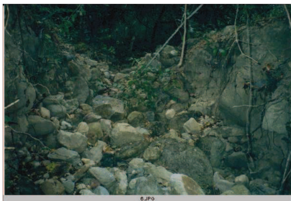
6-B. dique de Retención destruido por efecto de la escorrentía
