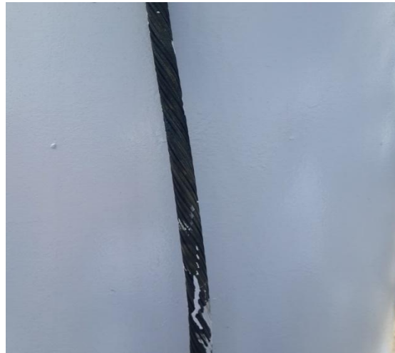
Figura 23. Corrosión en la red puesta a tierra ubicada en la Subestación de la planta geotérmica de Berlín. (Fotografía tomada durante visita de campo).
