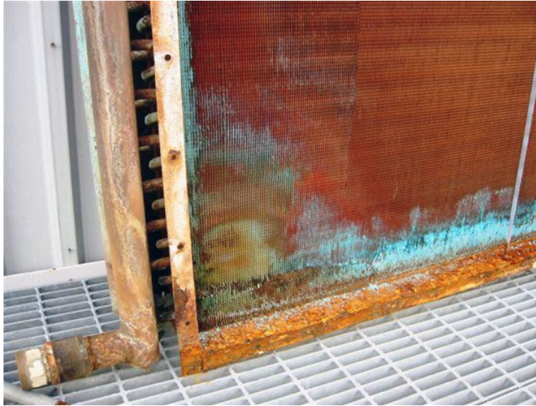
Figura 22. Corrosión en aires acondicionados causados por el H 2 S.
