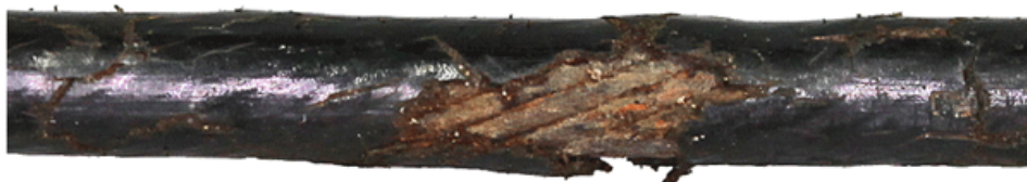
Figura 20. Cable con corrosión.
