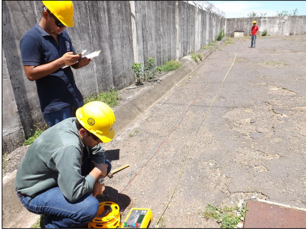
Figura J.13 Método de caída de potencial 62% dentro de la subestación 3
