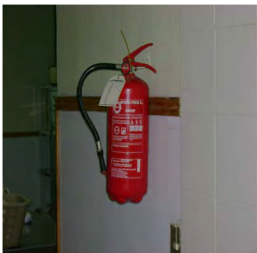
Figura 5 Extinguidor de fuego
