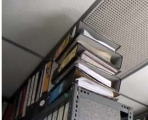
Figura 16. Apilamiento hasta el techo de material inflamable.
