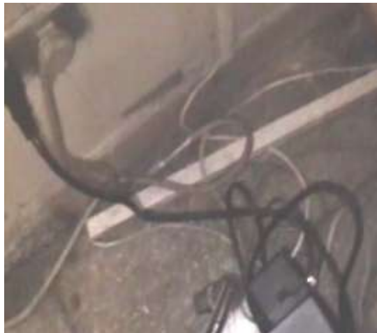
Figura 24. Amontonamiento de cables en el piso.
