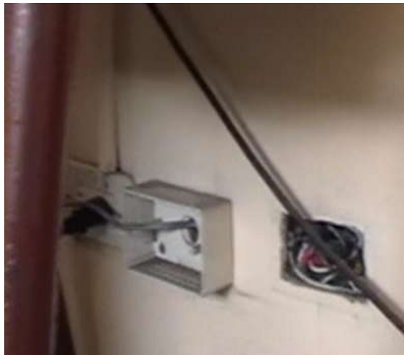
Figura 20. Tomacorrientes sin sus cubiertas protectoras.
