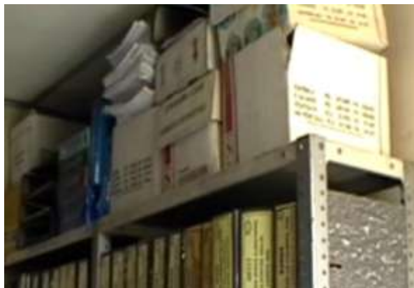
Figura 15. Apilamiento hasta el techo de material inflamable.
