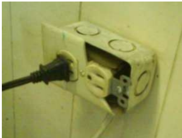
Figura 18 Tomacorriente de la coordinación de infraestructura.
