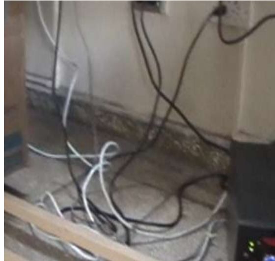
Figura 25. Amontonamiento de cables en el piso.
