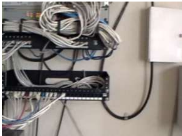
Figura 22. Conexiones eléctricas cercanas al área de trabajo.
