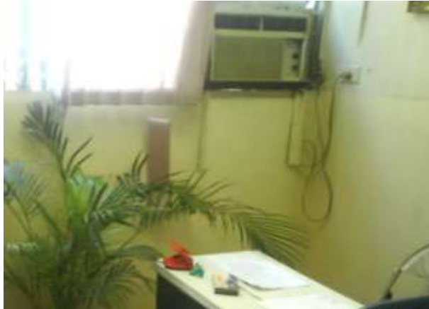
Figura 30. Aire acondicionado en el área de Gestión Financiera
