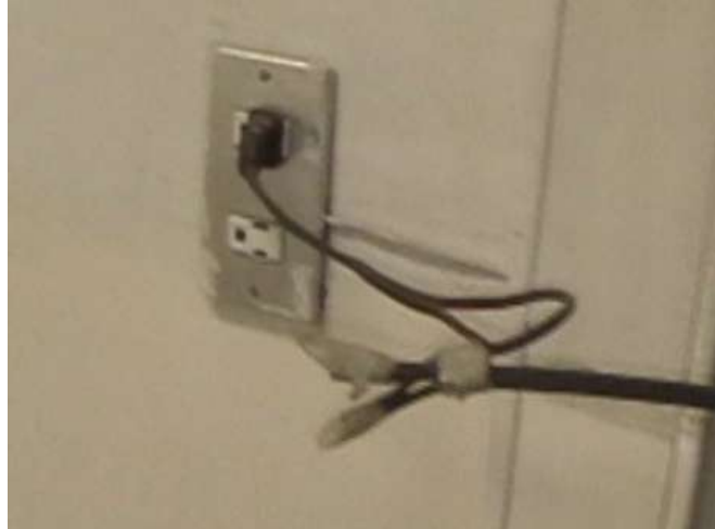
Figura 23 Mal aislamiento de los cables conductores de electricidad.
