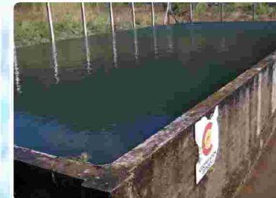
Tanque de almacenamiento de agua para riego.
