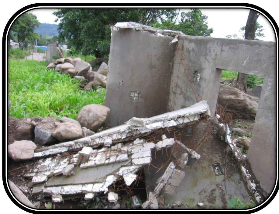
FOTOGRAFIA 5: CASA EN RUINAS (CONSTRUIDA EN FORMA PRE FABRICADA DEBIDO A DESASTRES ANTERIORES)
