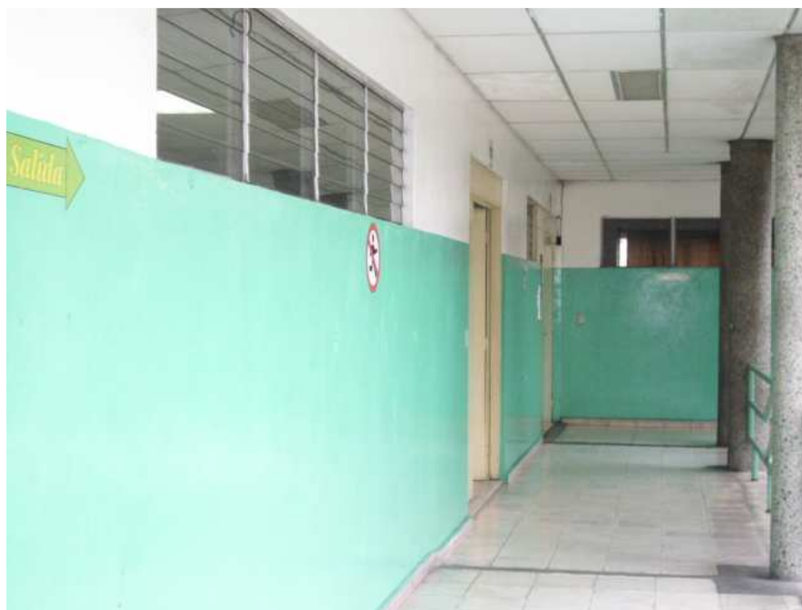
Señalización en pasillos de aulas del segundo nivel
