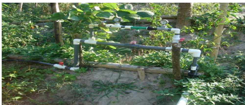
Sistema de Riego por Goteo
