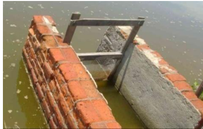
Imagen No. 31 - Filtro en compuerta de estanque
