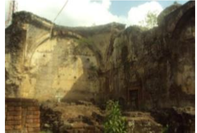
Foto: 1 Iglesia Colonial en Ruinas . La foto muestra el sector en donde se encontraba ubicado el Altar Mayor.
