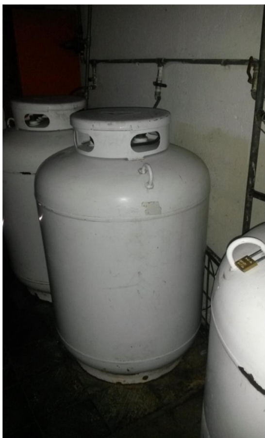
Imagen 4 Cilindros industriales de gas
