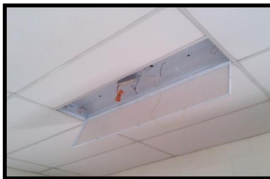
Fig. N° 7 Iluminación en malas condiciones presente en el cafetín Domingo Savio C6
